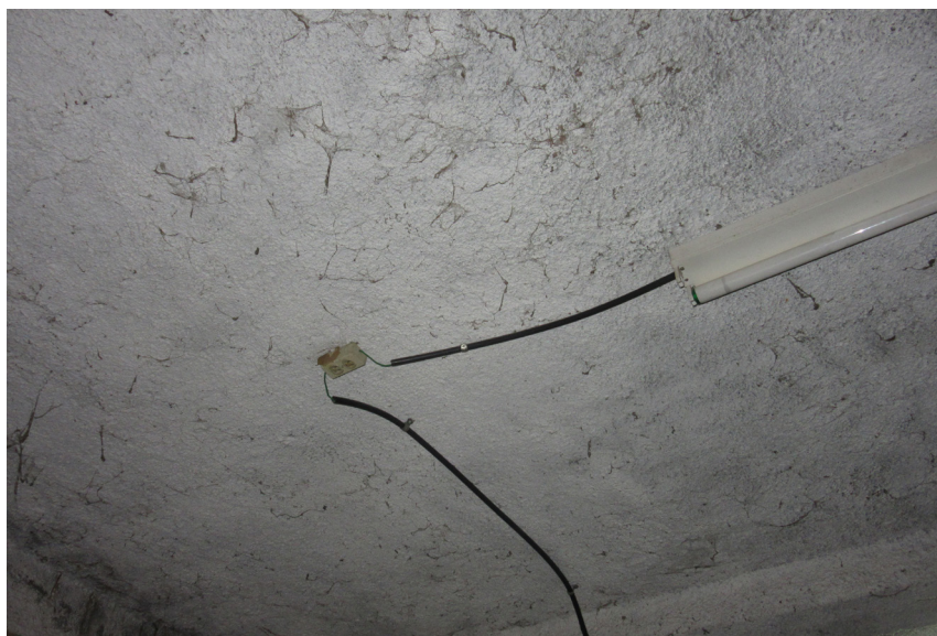
Figura 1. Toma de energía eléctrica en el colegio B
