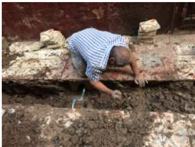
Figura 15 Evidencia de pérdida de agua potable por filtraciones
