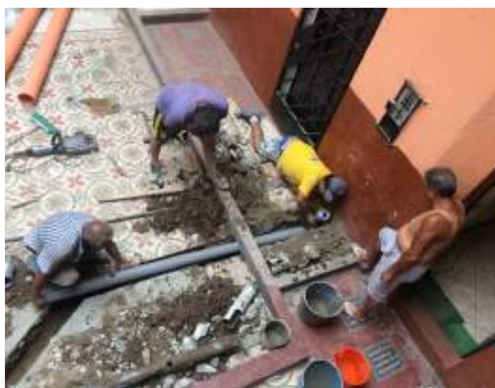
Figura 9 Instalación de tubería de PVC en la troncal del sistema de desagüe de la Quinta Baselli
