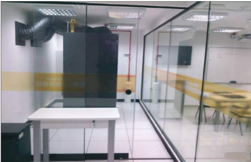
Figura 12. Data center con vista a mesas de trabajo
