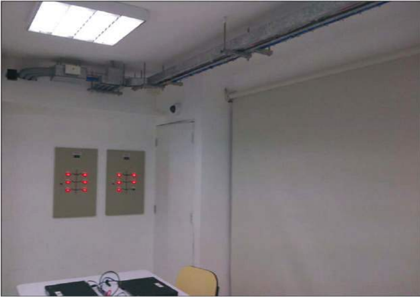
Figura 11. Cableado aéreo en área de alumnos
