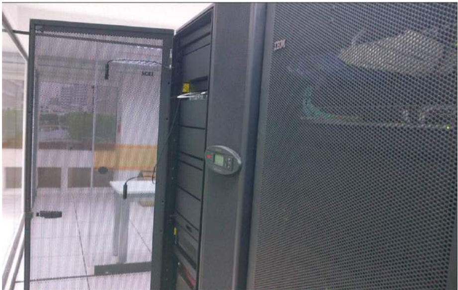
Figura 9. Gabinetes de equipos en el DC
