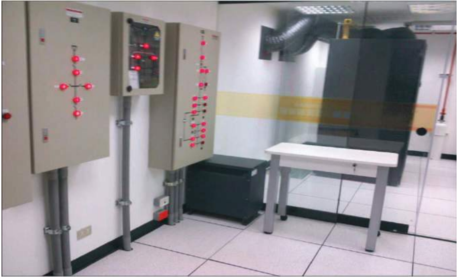
Figura 8. Tableros de distribución
