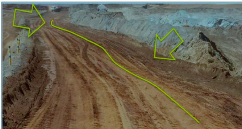
Figura 4. Depresiones en la vía
