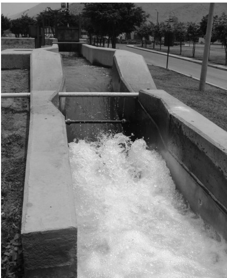
Figura 1 Mezcla rápida: Canales Parshall
