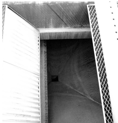
Figura 4 Tolvas de recolección de lodos
