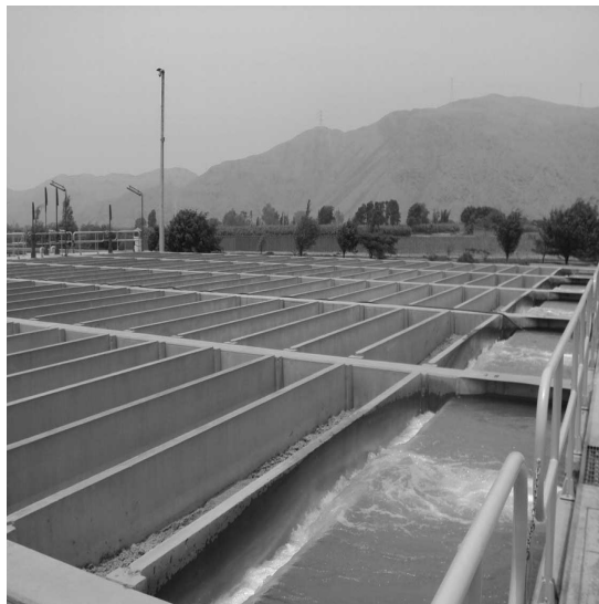
Figura 2 Mezcla rápida: Canales Parshall
