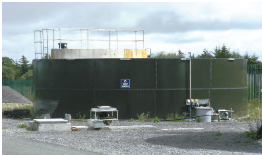
Figura 3 Cámara de entrada subterránea (al frente) y tanque de estabilización (atrás)
